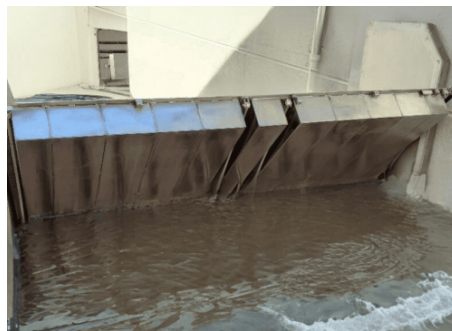
Figure 1 – Barrière anti-inondation protégeant une entrée de parking souterrain [1]
