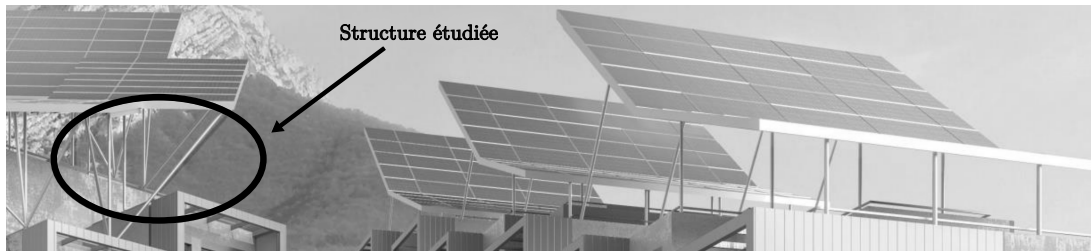
Figure 12 – Représentation des panneaux et de leur structure de maintien.
